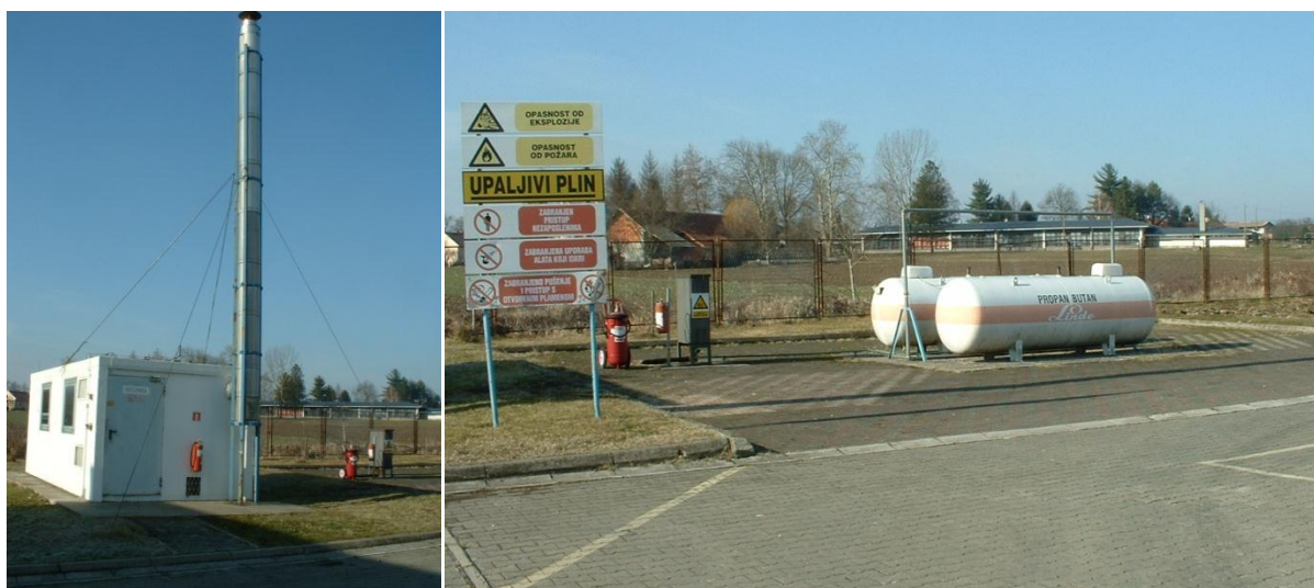
Slika 4: Kotlovnica i spremnici plina
